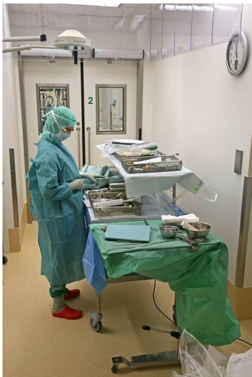
Uppdukningsrummet i Mölnbald med kvadratisk LAF -tak med spoiler. Här sker uppduknning på ett extra stort instrumentbord. Uppdukningsrummen är förberedda med medicinska gaser för att vid behov kunna fungera som förberedelserum.
